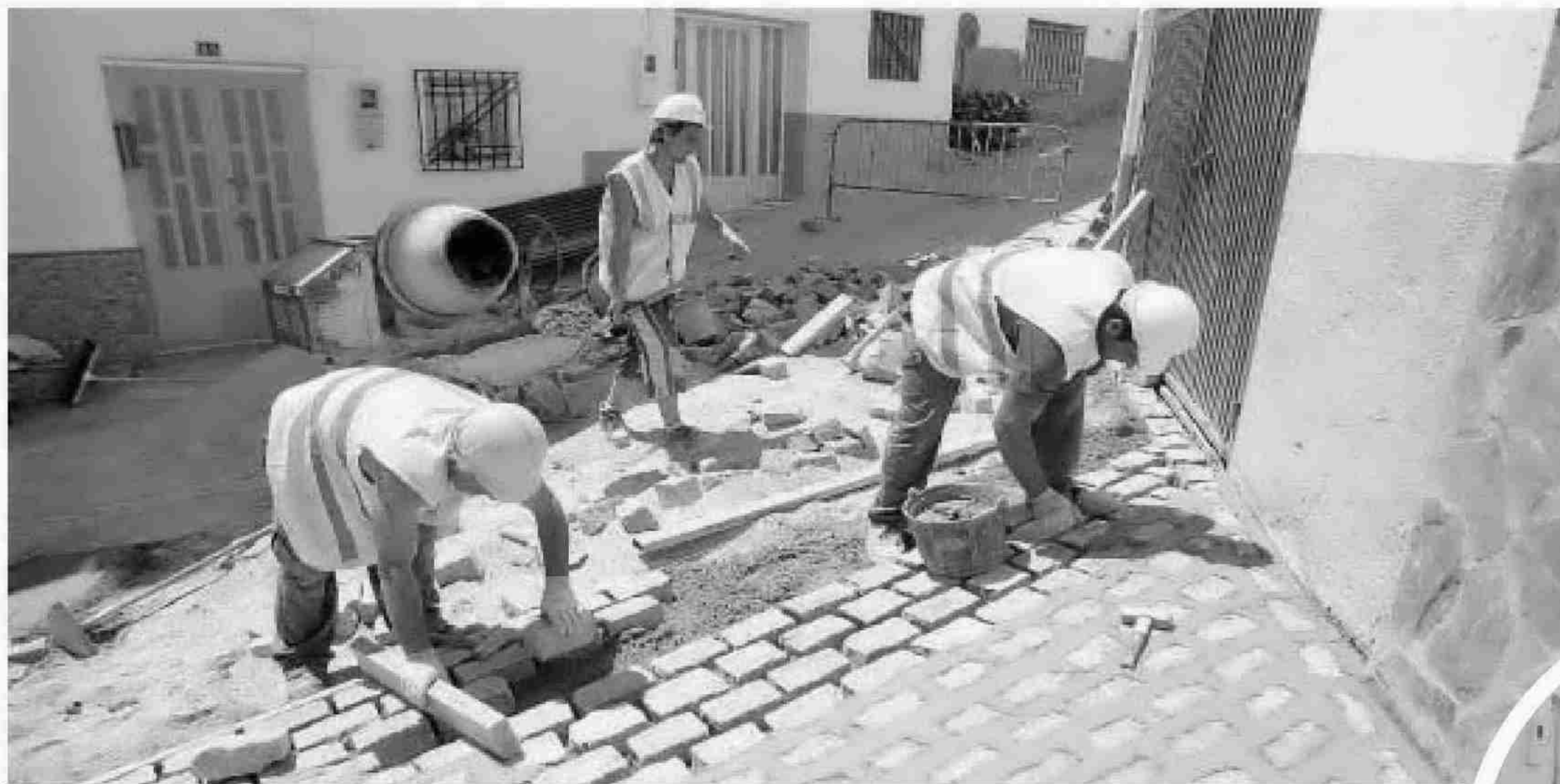
Francisco Diego Moreno (al fondo) trabaja en el adoquinado de la calle Olmo en el barrio Honda.
