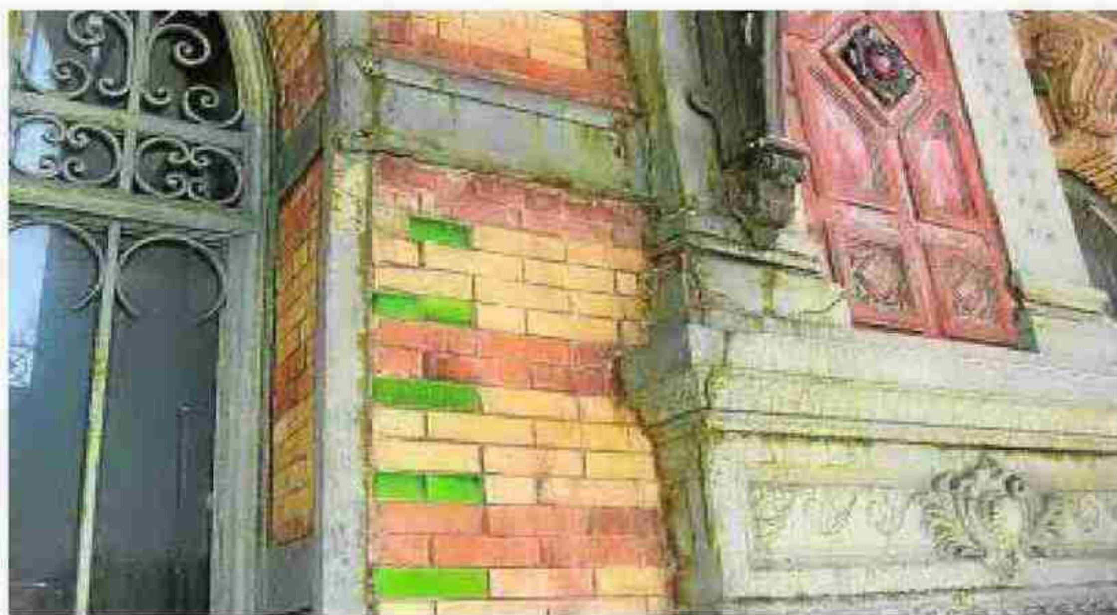
Los daños se extienden por toda la construcción.
