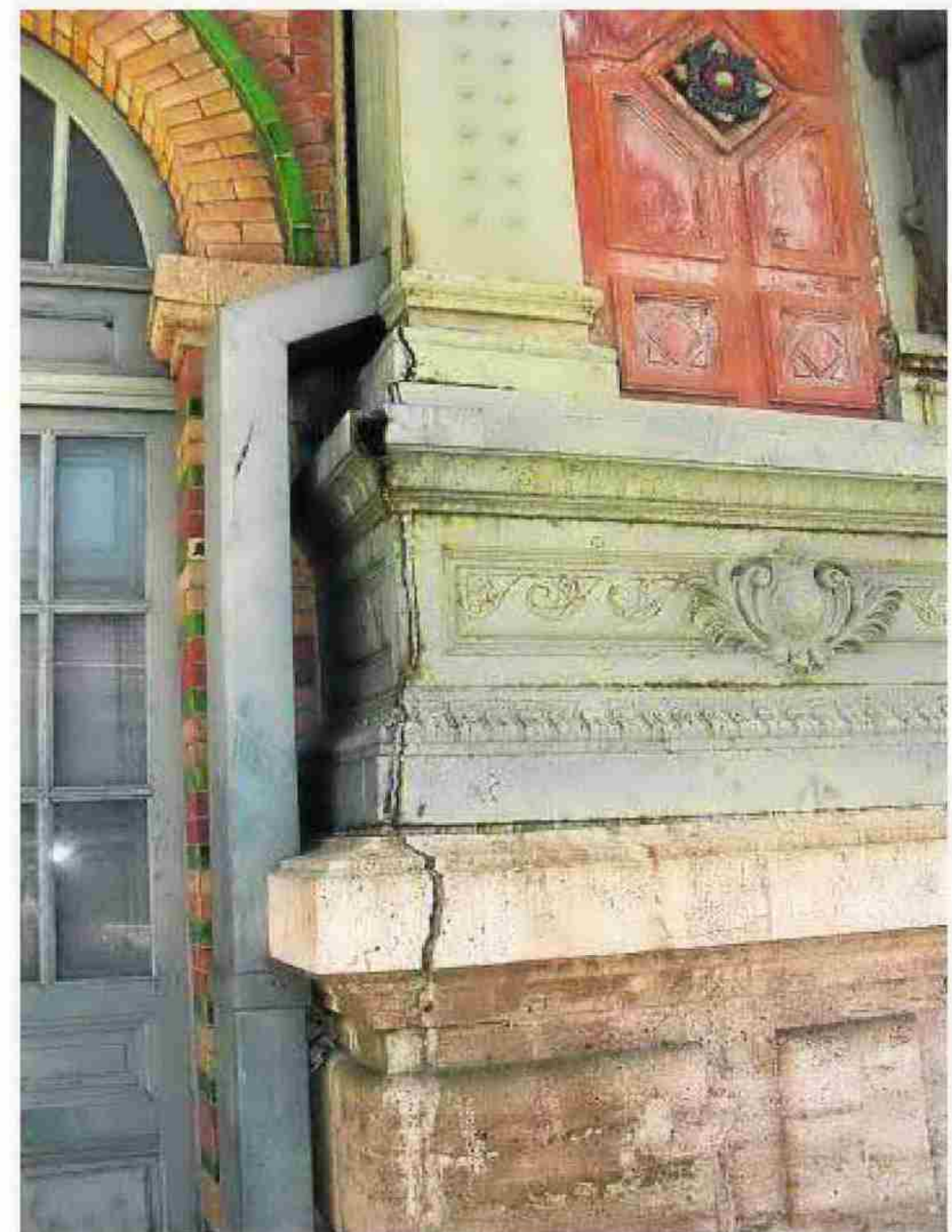
En caso de no actuar, la estación sufrirá daños mayores.
