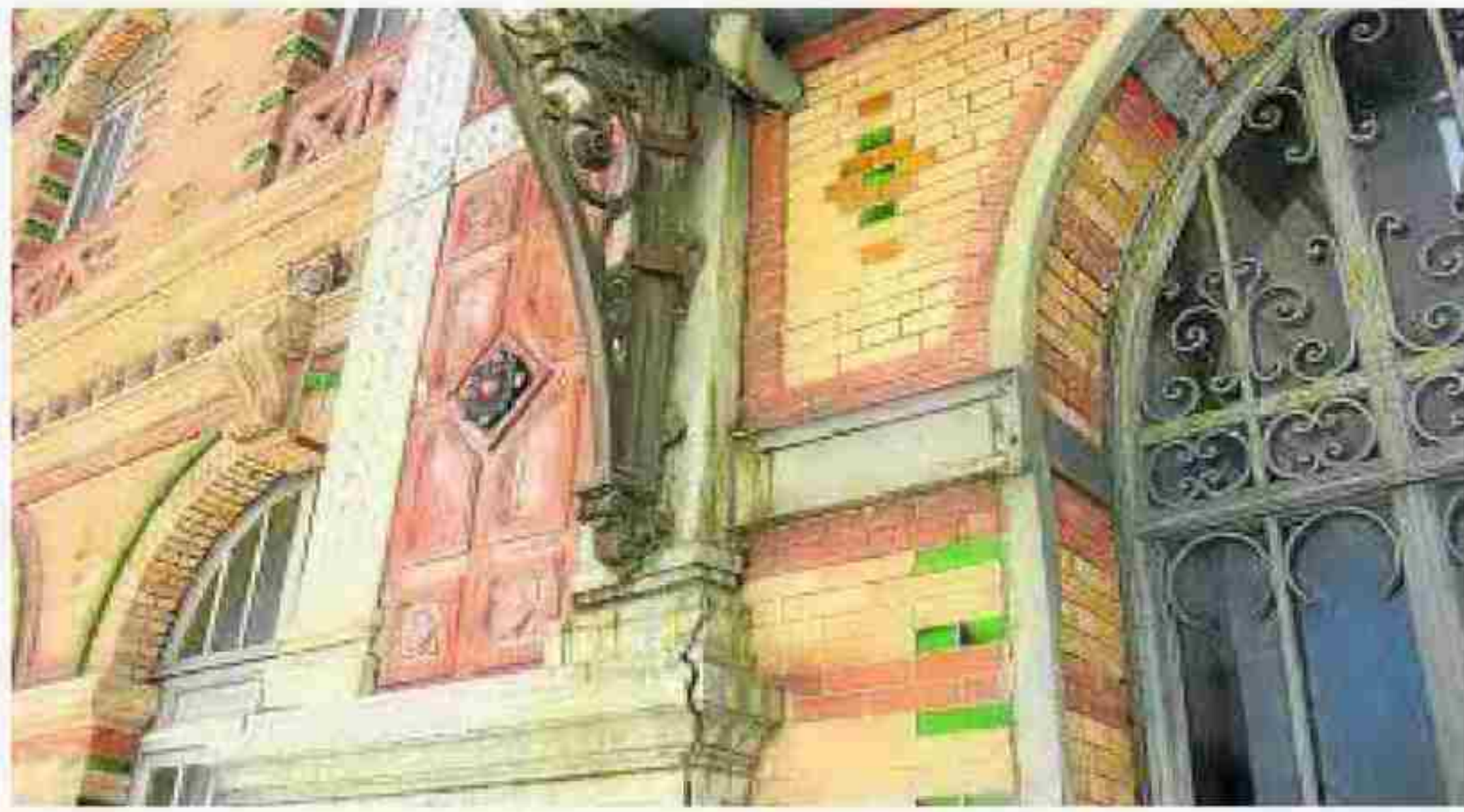
Las grietas aparecen como arrugas por el edificio.
